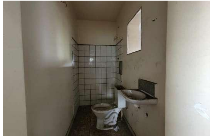
Figura 36 – Banheiro segundo pavimento
